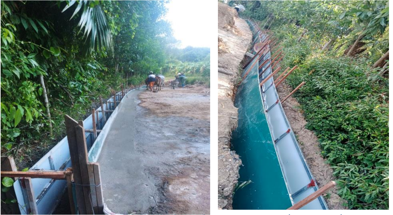
Hình 8: Làm rãnh thoát nước ở cụm số 5 và đổ đường bê tông tại tuyến đường nội đồng
